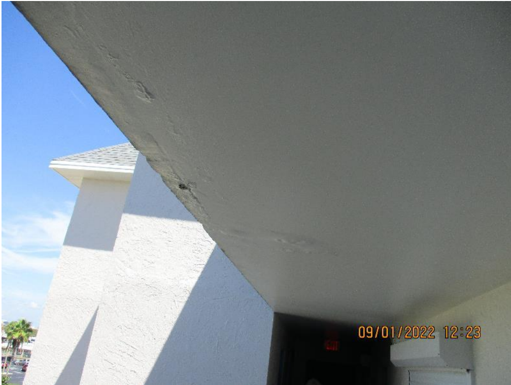
Edge spall on walkway
