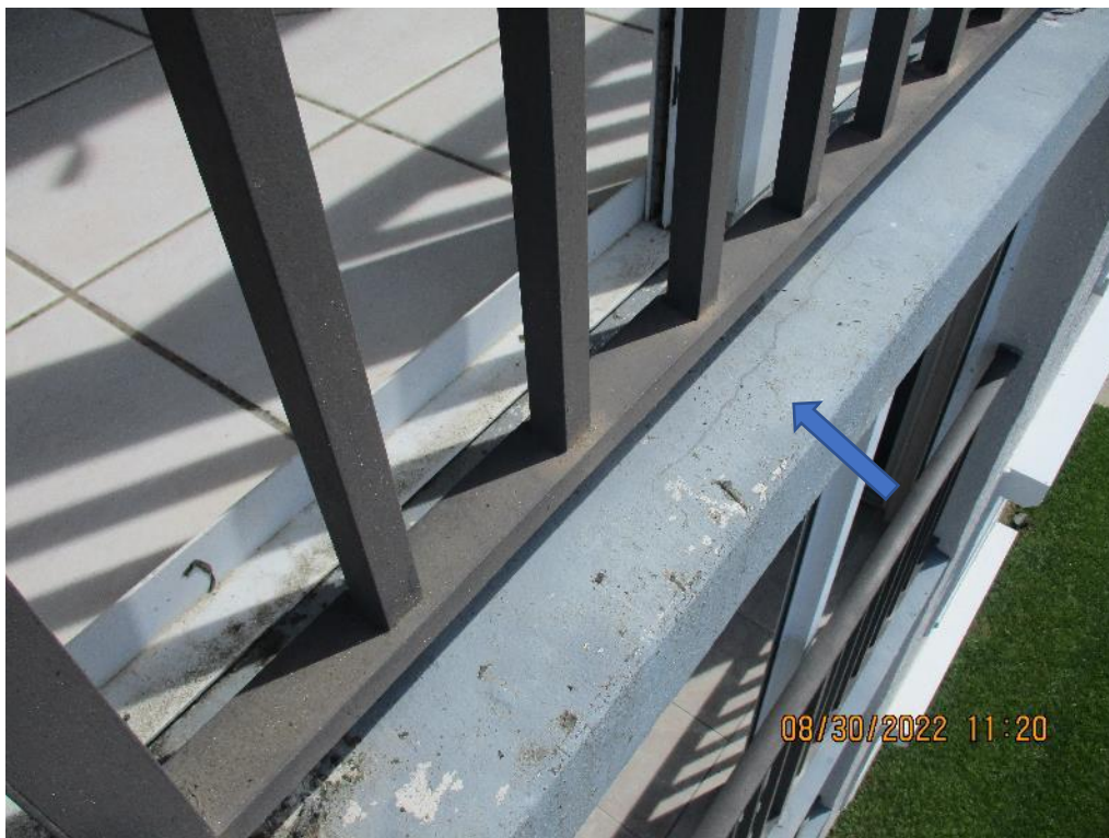
Edge spall due to reinforcing steel corrosion
