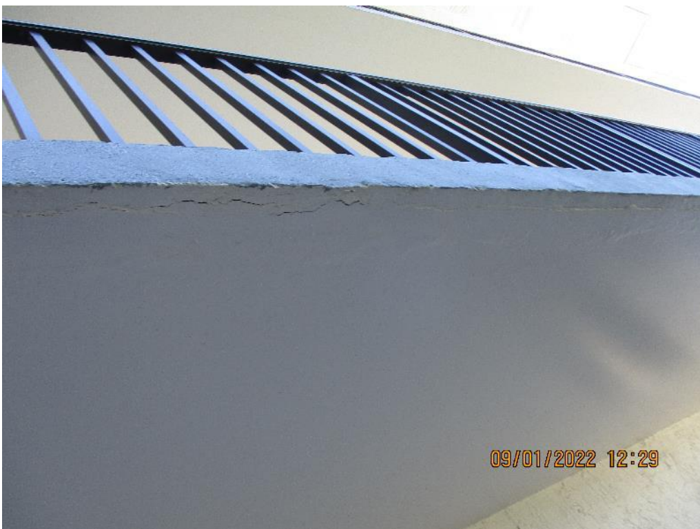
Edge spall on walkway
